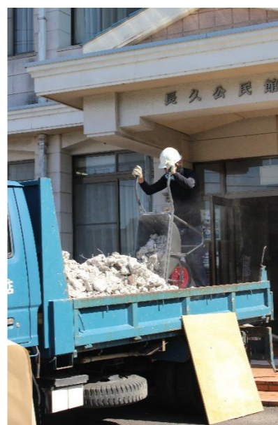
まちセン駐車場は工事車両が出入りするほか、配管工事が行われるため利用できません
