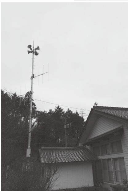
▶朝山町まちづくりセンターに設置されている防災行政無線
