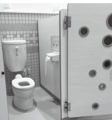
▲サンチャイルド長久さわらび園の洋式便器
