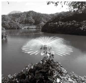
▲三瓶ダムに設置してある噴水(水質保全設備)
