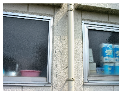
久手幼稚園外壁亀裂
