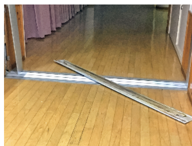
北三瓶小学校アルミカバー破損
