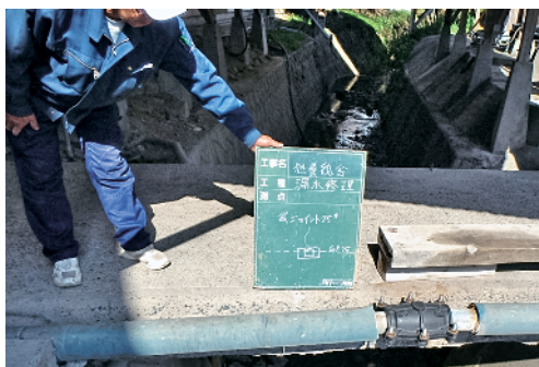
配水管VPφ75破損 （最大影響範囲120戸）
