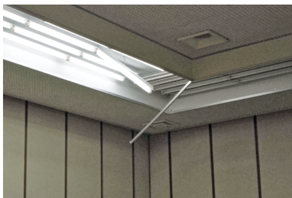
本庁舎4階全員協議会室内照明機器破損
