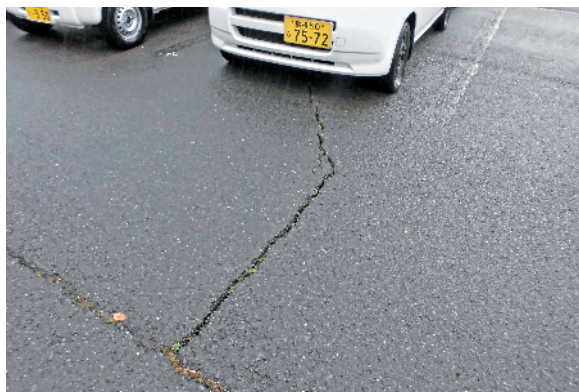
本庁舎東側駐車場内クラック
