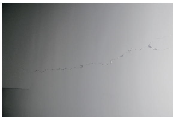
本庁舎内壁のクラック
