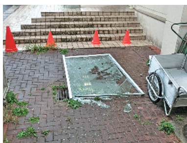
朝波小学校体育館サッシ破損
