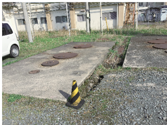
地下タンク廻り陥没
