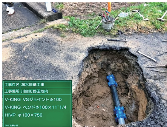
川合町野田地区φ100漏水 作業断水による断水件数44戸
