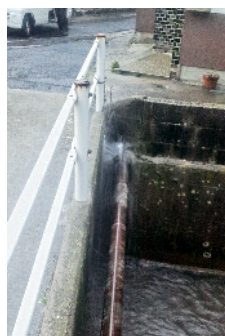
水管橋φ100コンクリート巻き立て付近 で漏水
