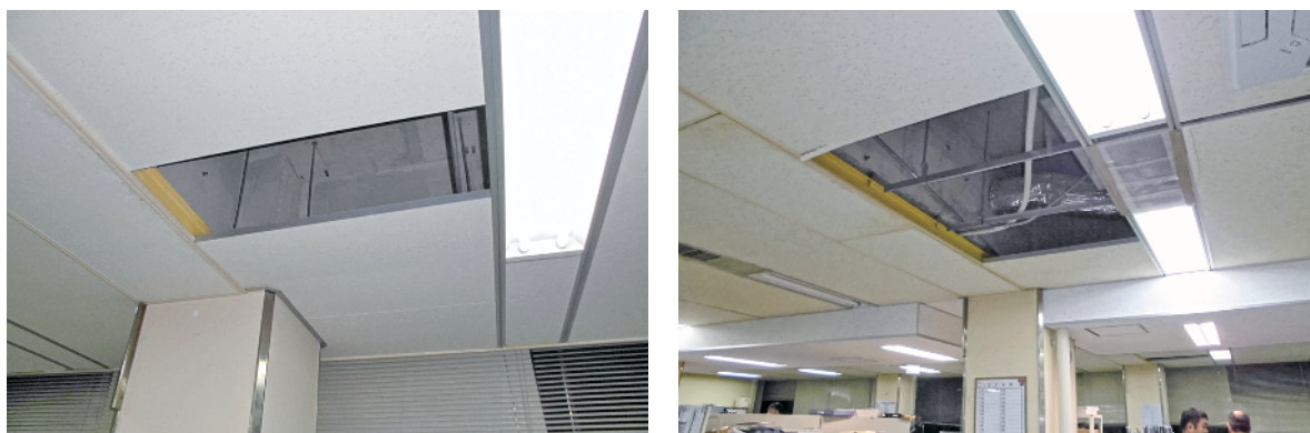
本庁舎 3階下水道課執務室内天井板落下
