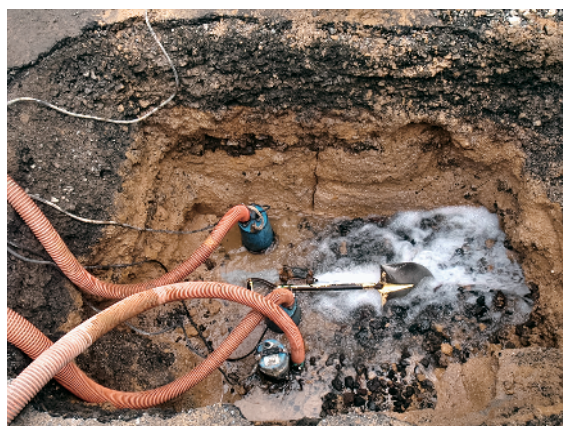
配水管VPφ150破損 作業断水による断水件数16戸
