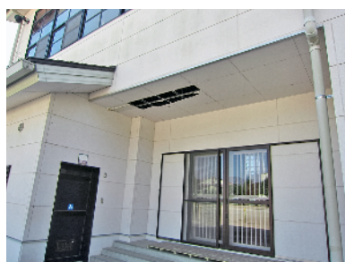
大田小学校体育館軒天井破損
