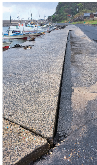
漁港被害（波根東漁港）
