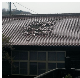
（家屋被害【屋根】）
