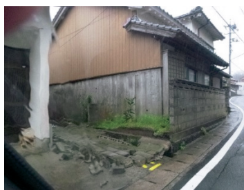
（家屋被害【ブロック塀】）
