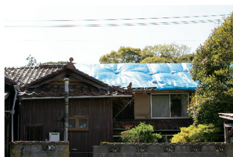
（家屋被害状況）
