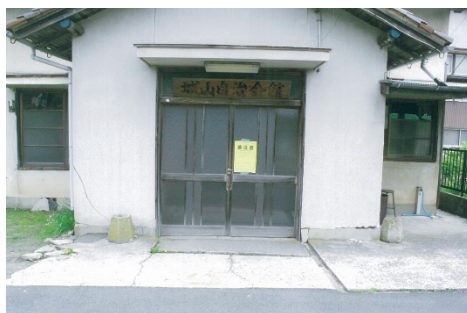
（自治会館破損状況）
