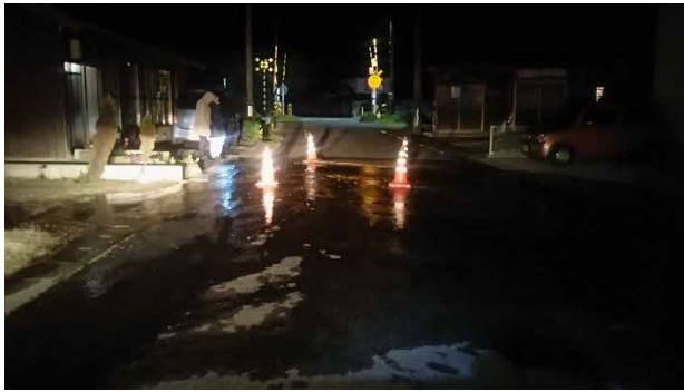
久手町 石綿管 φ150mm 破損状況
