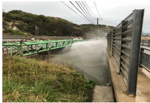
久手町 掛戸水管橋鋼管 φ200mm 破損状況
