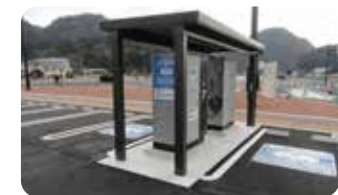
14 EV充電設備
