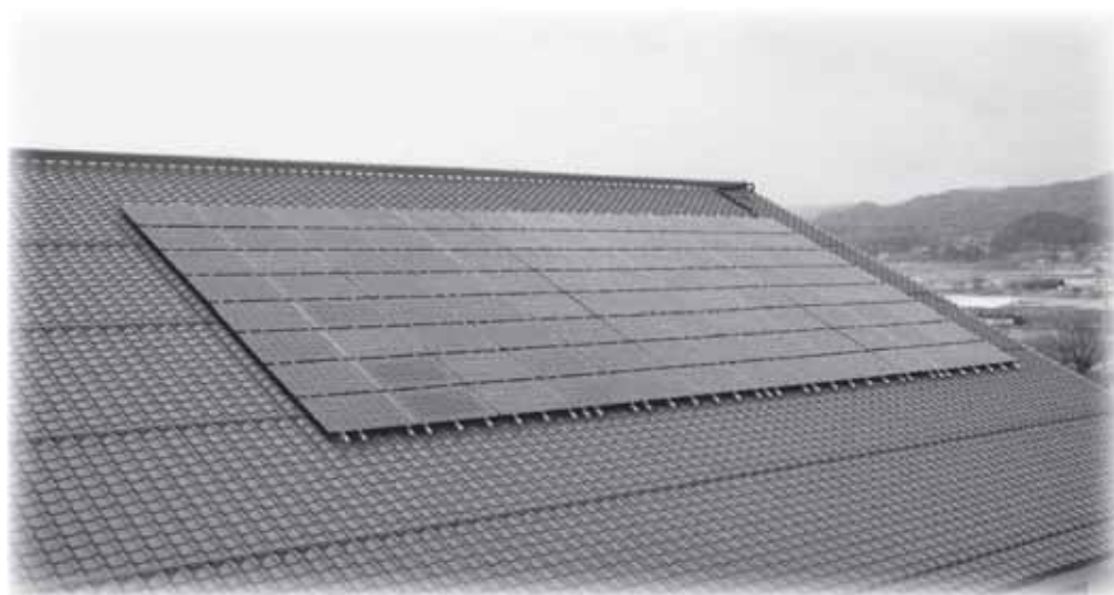
久手小学校体育館の太陽光パネル (20kw)
