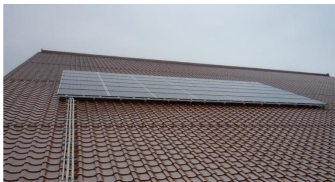
井田まちづくりセンター太陽光パネル
