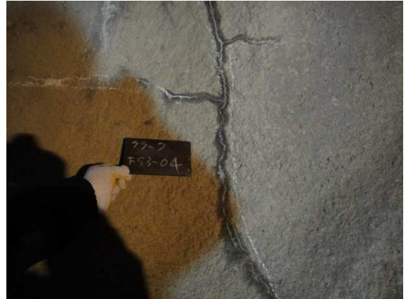
吹付部のひび割れ
