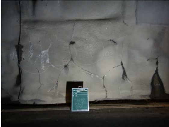
吹付部のひび割れ
