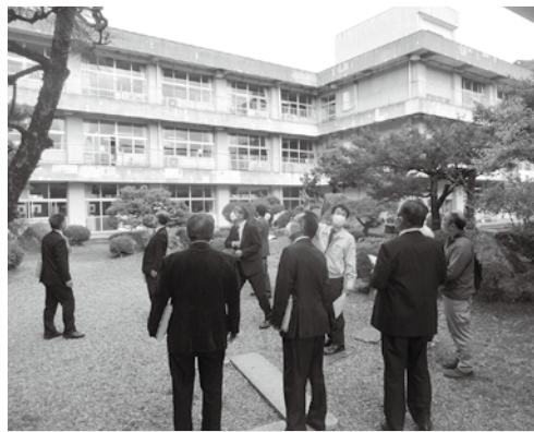
▲大田小学校(外壁の剥落が目立つ)
