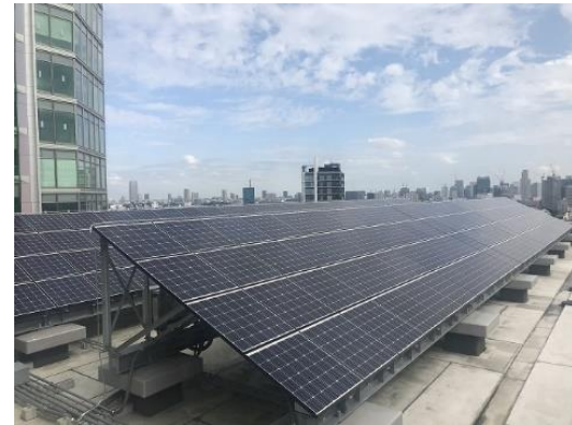
太陽光発電設備 (渋谷区庁舎)
