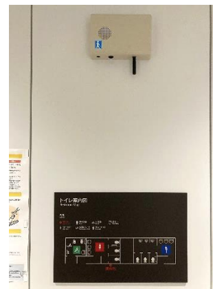
トイレ音声誘導装置 (岐阜市庁舎)
