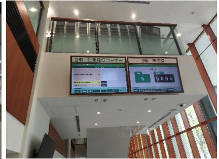
番号表示モニター (博多区庁舎)
