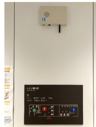
トイレ音声誘導装置 (岐阜市庁舎)
