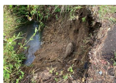
市道角折線路肩陥没
