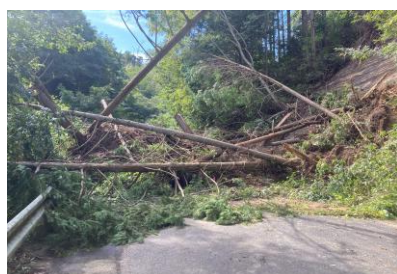
延屋農道土砂崩れ（倒木）
